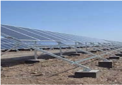
Structures pour panneaux solaires
